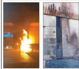
Links: 'n Skermgreep vanaf 'n Facebook-plasing op die groep Oudtshoorniete Staan Saam. Regs: Die skade was ooglopend, maar beperk.
